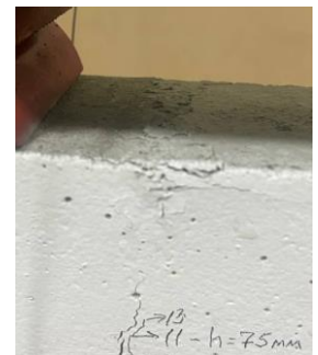
Разрушение сжатой зоны бетона
