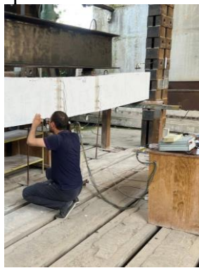
Процесс измерения трещин
