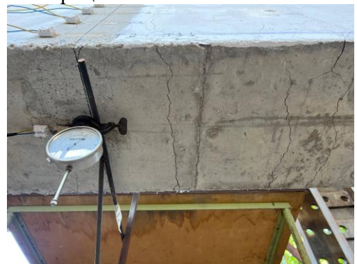
Нормальные трещины в зоне чистого изгиба
