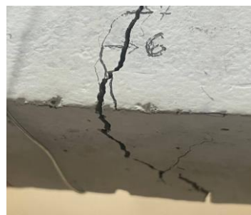
Нормальные трещины в зоне чистого изгиба
