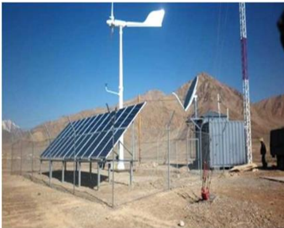
Рисунок 3.3. – Ветро-солнечная гибридная электростанция в Мургабском районе
